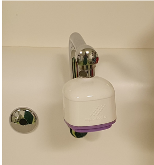
Fig. 1 : Filtre au point d'usage permettant l'obtention d'EBM
